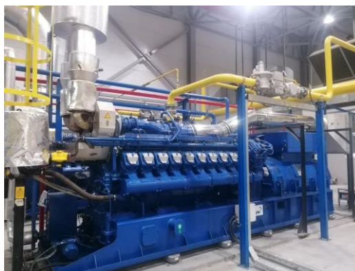
Рис. 1. ГПУ MWM TCG 3020 V20 в машинном зале мини-ТЭЦ Чиланзар (акустическая обшивка здания)
