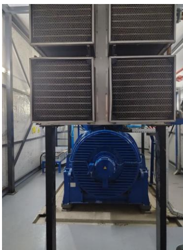
Рис. 4. Перфорированные звукопоглощающие панели кожуха и радиаторные секции (Сергели) Fig. 4. Perforated sound-absorbing panels of the enclosure and radiator sections (Sergeli)
