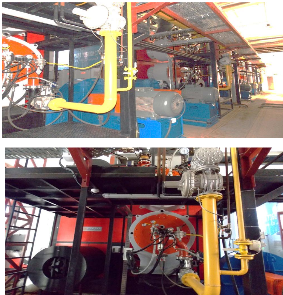
Рис. 1. Котельная «Юбилейная» в Чирчике Fig. 1. The “Yubileynaya” boiler house in Chirchik
