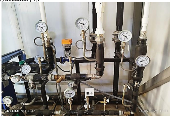
Рис. 2. Индивидуальный тепловой пункт
