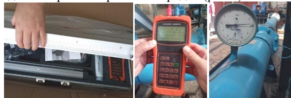
Рис. 1. Измерение параметров насосов Figure 1. Measurement of Pump Parameters
