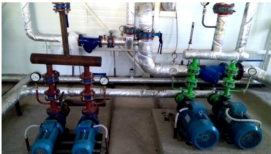
Рис.4. Насосное оборудование на котлах производства НПП «Истал»
