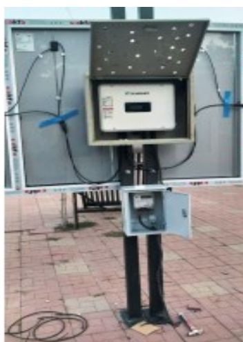
Рис.5. Фото соединения ФЭП установки через инвертор и счетчик в локальную сеть. Fig.5. Photo of the connection of the PVP installation through the inverter and a meter to the local network.
