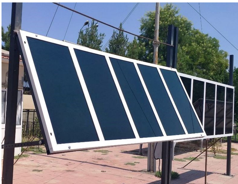
Рис.11. Фото наклонной PV1 и вертикальной PV2 частей ФЭУ. Fig.11. Photo of inclined PV1 and vertical PV2 parts of the PVI.
