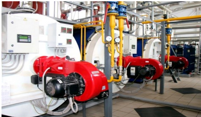
Рис. 1. Установка водогрейных котлов серии КВа, мощностью 1,5 МВт (10,75 Гкал/час) (источник: фото автора)
